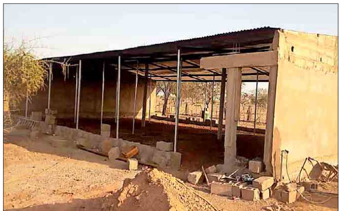
Mit dem neuen Hühnerstall-Projekt soll zum einen die Nahrungsmittelversorgung vor Ort verbessert werden. Zum anderen soll es dazu beitragen, dass das Ökozentrum künftig autonom wird.
